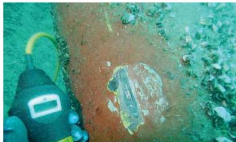
Da riparare. Le condotte fognarie sono corrose in molti punti
