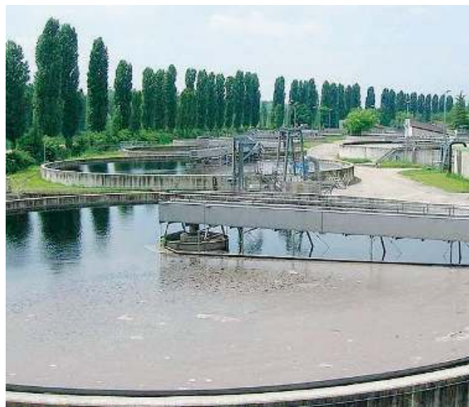
L'attuale impianto. Il depuratore di Peschiera
