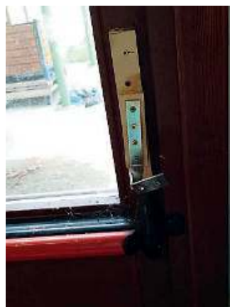
Danni. Una delle porte forzate
