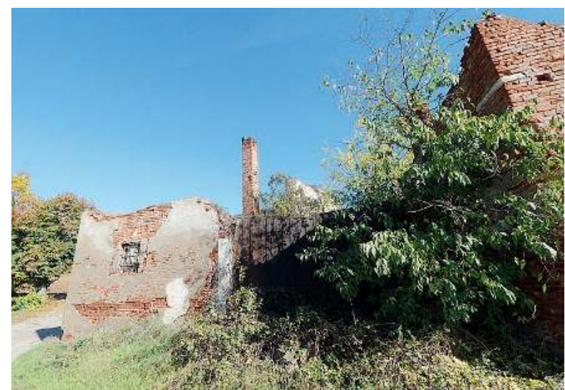
Ruderi. In futuro anche queste strutture potrebbero essere ristrutturate
