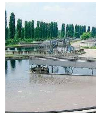
Trattamento. Un depuratore
