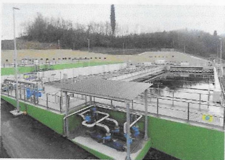
Paesi. L'impianto di Gavardo serve anche Vallio Terme e Villanuova
