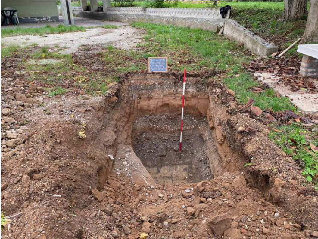
SONDAGGIO 6: GENERALE DA SUD, È PRESENTE UN SOTTOSERVIZIO
