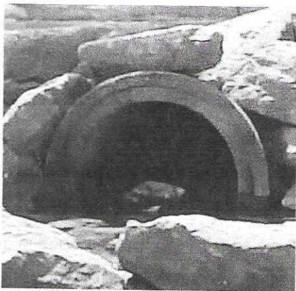
A rischio. In caso di forti piogge il sistema cede
